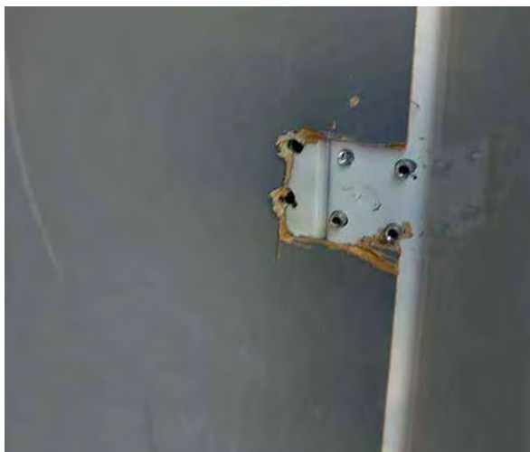
Vidljivi tragovi demontaže u utovarnom prostoru
