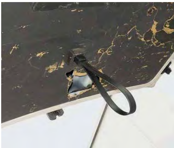
Teško oštećena unutrašnja obloga
