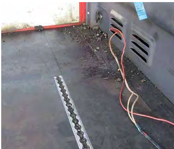
Nepravilno ožičenje izvedeno od strane korisnika
